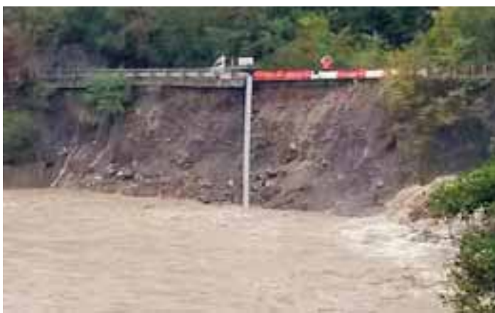
La frana sotto la 45 a Ottone; per 4 mesi il transito è stato a senso unico alternato
