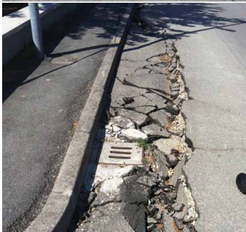
Effetti della liquefazione sulle infrastrutture.
