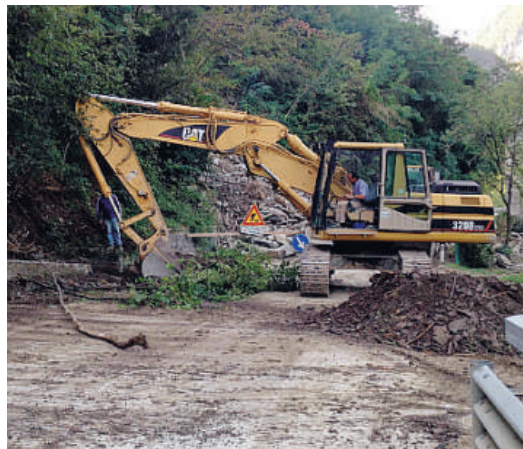
FERRIERE - Interventi tamponi sulla provinciale Valdaveto bloccata da una serie infinita di smottamenti (foto Malacalza)
